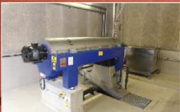
➡ Unité de déshydratation (centrifugeuse).
