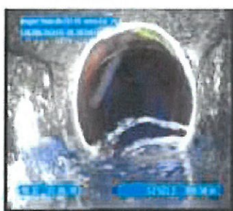
Infiltrations regard 31, route de Bérat
