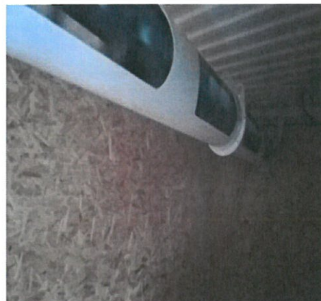
La vis horizontale dans le silo en partie haute qui déverse le bois déchiqueté dans le silo (43 m 3 de bois ont été approvisionnés)
