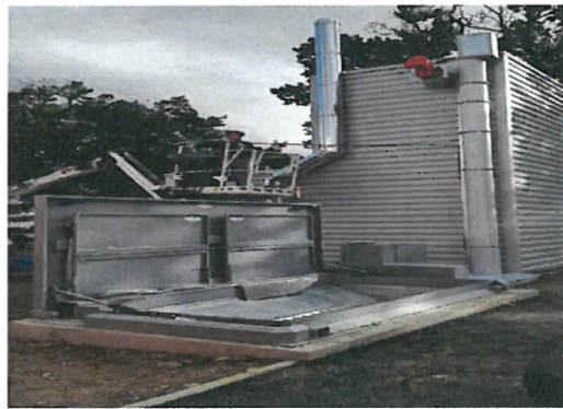
La trémie de déchargement qui reçoit le bois déchiqueté avec le système de vis en partie basse, reliée à la vis verticale carénée, elle-même reliée à la vis horizontale en partie haute du silo, qui approvisionnent le bois déchiqueté dans celui-ci.
