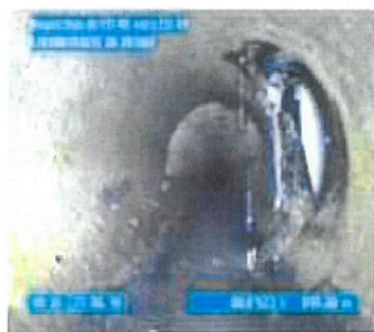
Infiltration au branchement, route de Bérat
